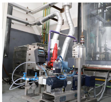
G4 – Actual Installation
