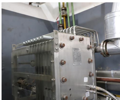
G4 – Actual Installation
